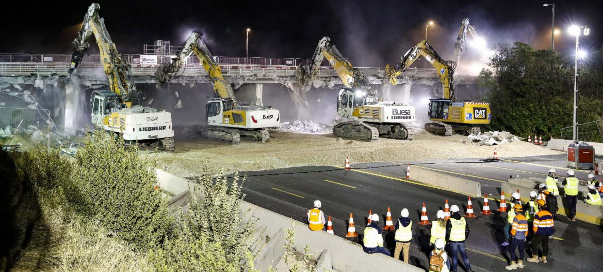
Destruction d'un pont sur la route de Vaugières road sur l'autoroute A709 octobre 2023 ©Vinci Autoroutes/Alain Tendéro
